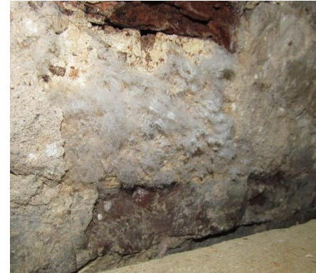
Выходы солей на поверхность кладки в интерьере
