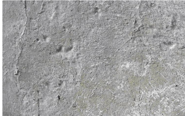
Отслоение штукатурки и образование солей
